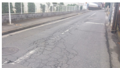
劣化し、路面にヒビが入っている道路(久米川町にて)
